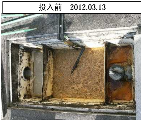
非常に強い悪臭。 表面の油は約 5 c m。
